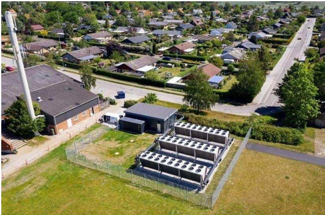
Abbildung 34: 1,2 MW Luft-Wärmepumpe in Slagslund Dänemark (Quelle: PlanEnergi)
